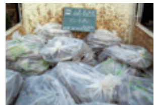
飛散しないように袋詰めされたアスベスト部材
