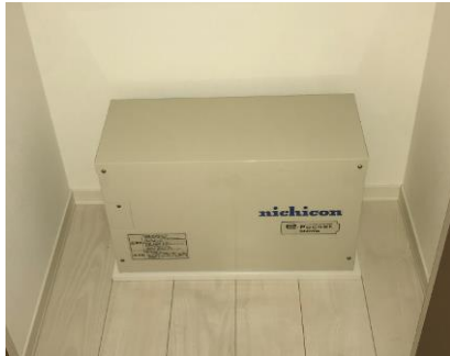
稼動している蓄電池で 停電時の動作を体感
