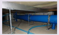
飲料水貯留システム
