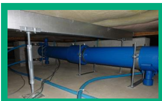
「飲料水貯留システム」
