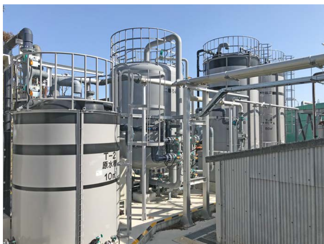
滋賀水口工場のろ過設備
