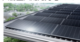
大容量太陽光発電システム
