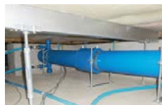
飲料水貯留システム
