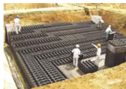
豪雨対策に貢献する雨水貯留システム
