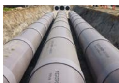
雨水貯留管としても活躍する強化プラスチック複合管
